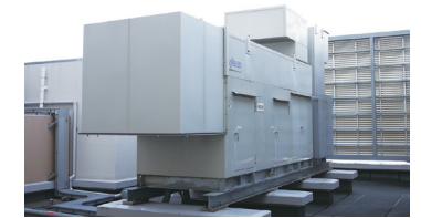
停電した場合には非常用自家発電装置が作動し、手術や医療機器への電源供給が途切れないようになっています。
